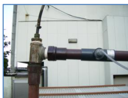
源泉井戸付近の配管へ
