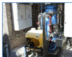
給水ポンプ付近へ
