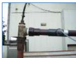
源泉井戸付近の配管へ
