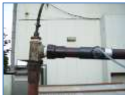
源泉井戸付近の配管へ
