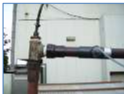
源泉井戸付近の配管へ
